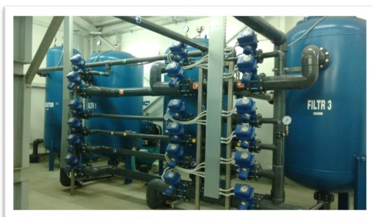
Fot.: Stacja Uzdatniania Wody w miejscowości Chociule, gm. Świebodzin
