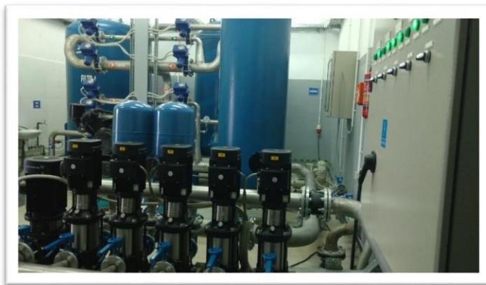
Fot.: Stacja Uzdatniania Wody w miejscowości Lubogóra, gm. Świebodzin
