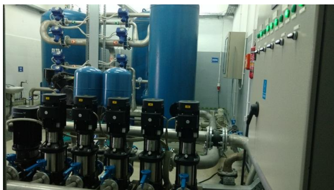
Stacja Uzdatniania Wody w miejscowości Lubogóra, gm. Świebodzin
