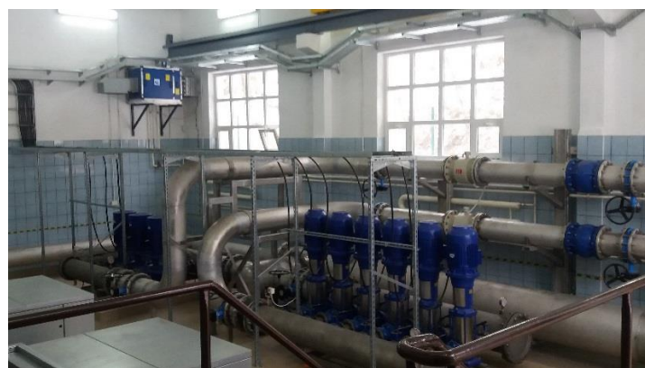
Stacja Uzdatniania Wody w Żaganiu.
